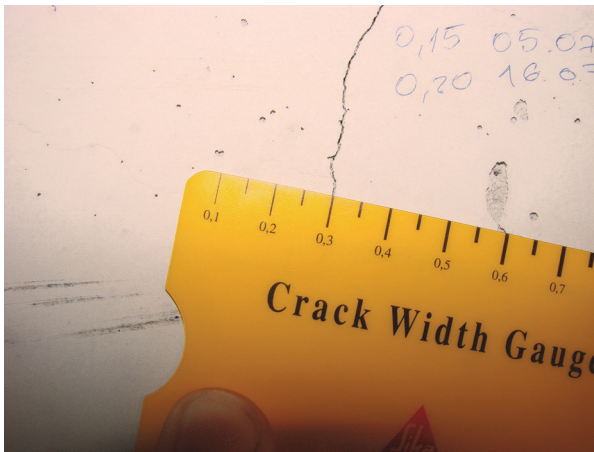
Slika 1. Mjerenje pukotina u armiranobetonskom zidu
