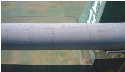
Slika 1. Pojava pukotina za stanje napreznja II i neraspucani dio između njih
